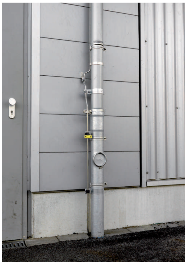
Рис. 2.18: Токоотвод молниезащиты на водосточном стояке
