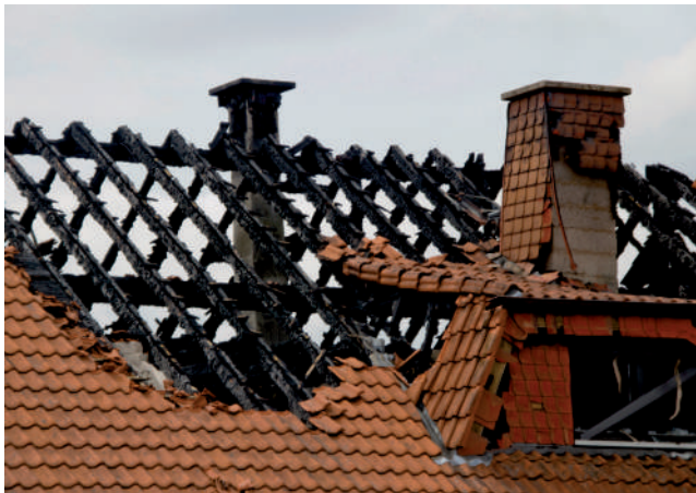
Рис. 1.19: Повреждения здания от прямого удара молнии
